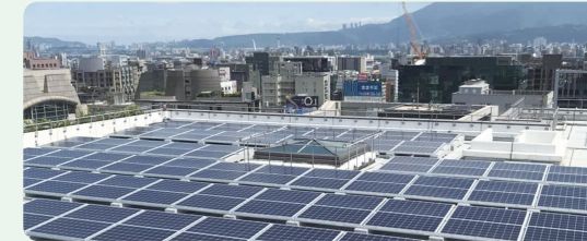
▼ 屋頂型太陽光電案場
