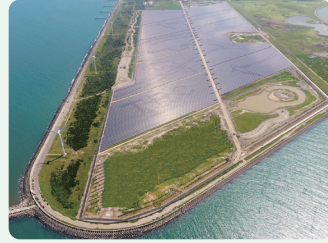
▼ 台電彰化彰濱100MW太陽光電
